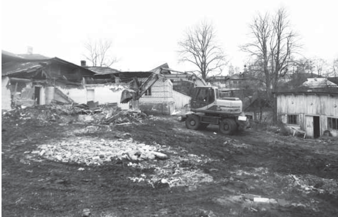
Работа по разрушению детского садика идёт ударными темпами. Работает бригада из Москвы.
